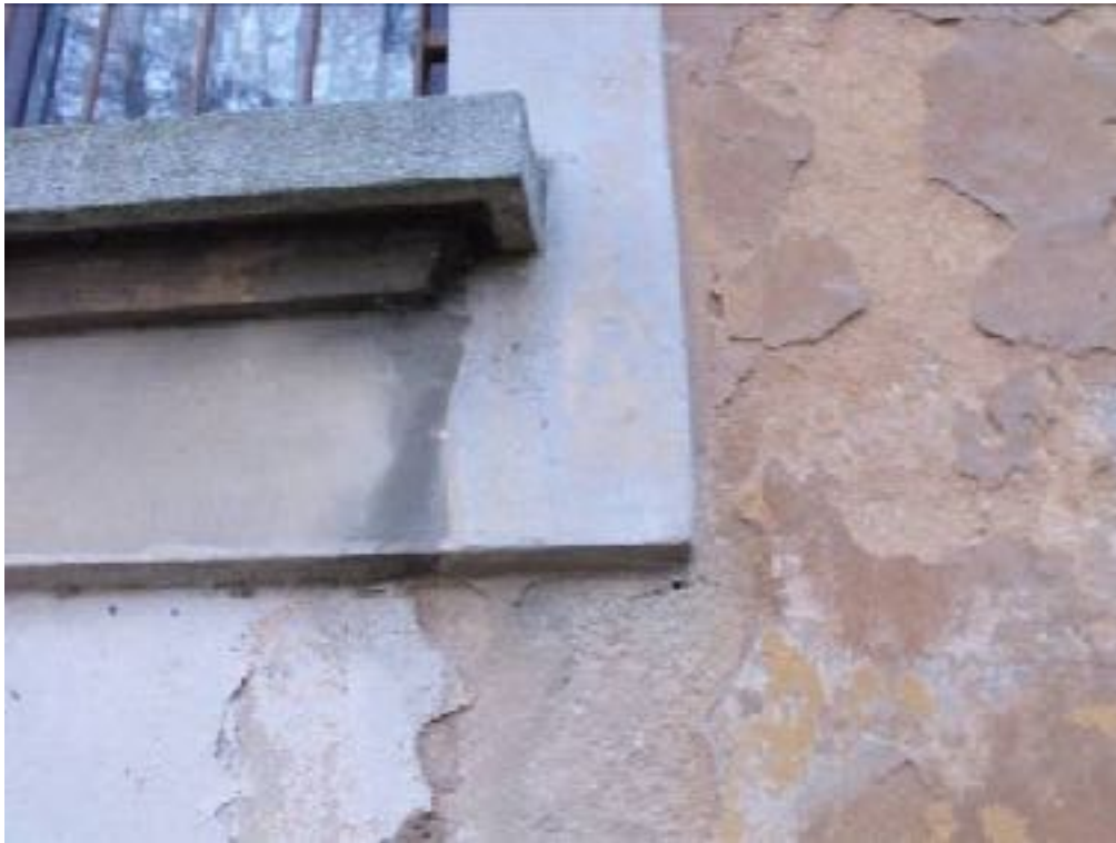
Figura 8 particolare degli stucchi eseguiti in loco e dell'intonaco degradato
