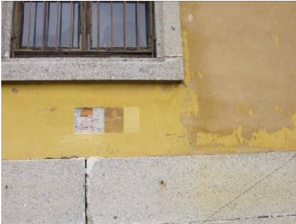
Figura 10 visione generale della stratigrafia n.1 eseguita sulla facciata principale
